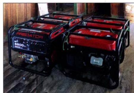
Die Stromversorgung erfolgte mittels vier Predator-Generatoren mit 5,5 kW im Dauerbetrieb.
